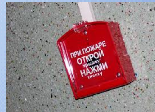
Отсутствует или неисправна пожарная сигнализация, не хватает средств пожаротушения
