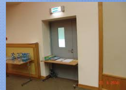
Отсутствуют запасные выходы или они захламлены
